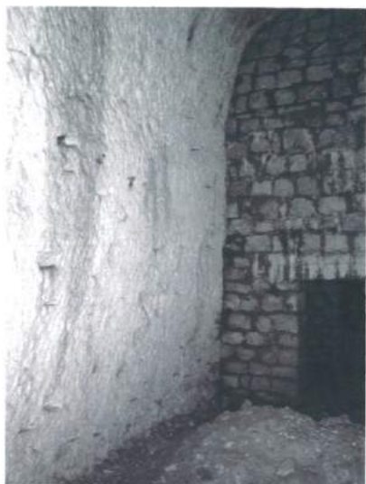
photo 15: vue d'un pilier et des consolidations sous le bâtiment 16 route de Louveciennes
