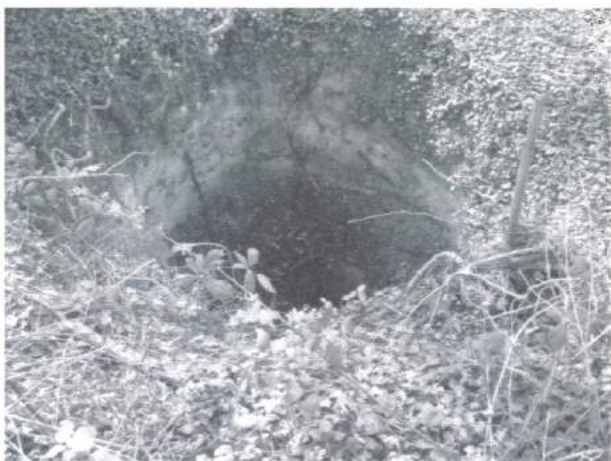
photo 7: Fontis en bordure du chemin du bas du parc
