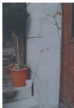
photo 26: exemple de fissuration du bâti
